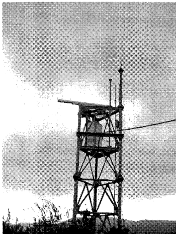
図3 レーダ波高計(空中線部)
