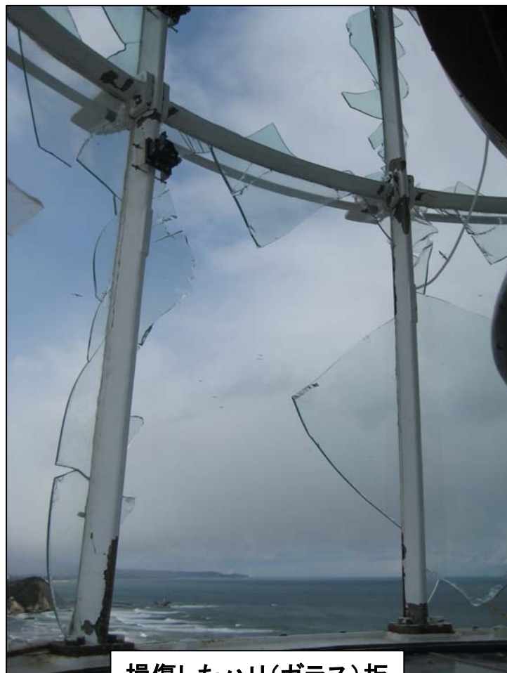
損傷したハリ(ガラス)板
