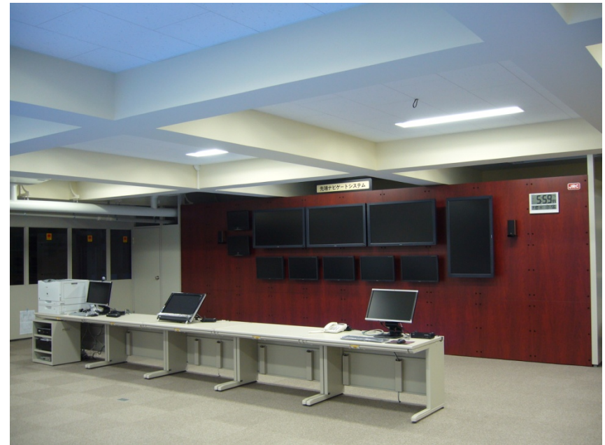
【監視表示ステーション】
