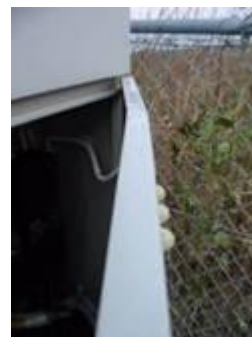
引き込み盤の扉の曲がり
