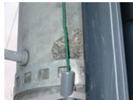
引き込み盤取り付け電柱の欠け
