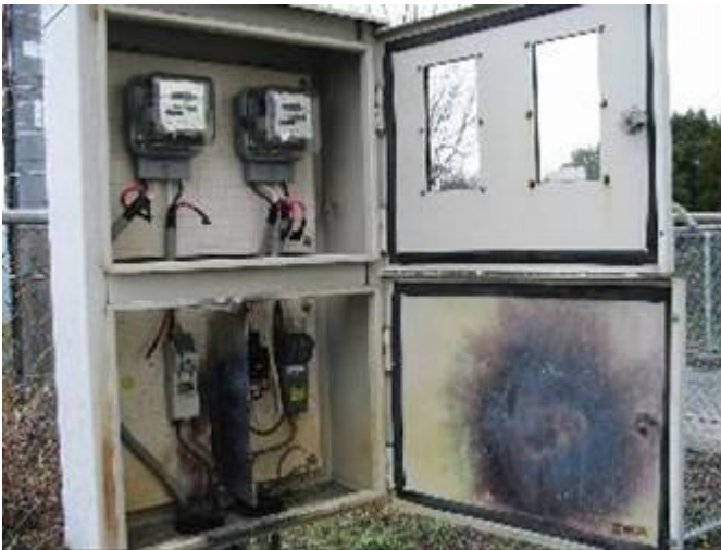
引き込み盤の被害
