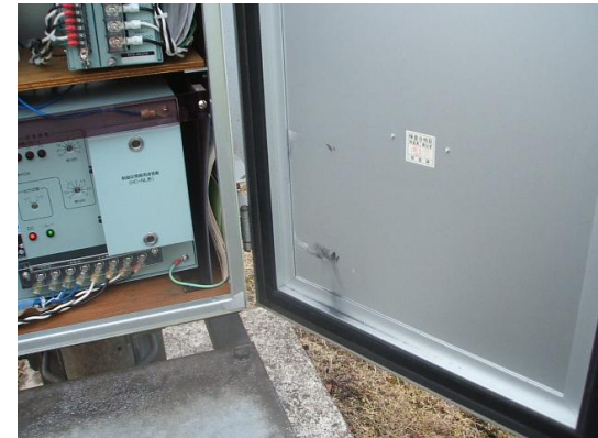
踏み切りの制御装置
