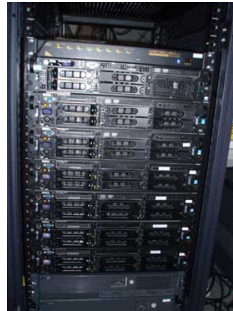
AIS各種サーバー(設置場所:横浜)
